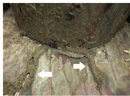
図 II-10 ヤマトシロアリの蟻道
